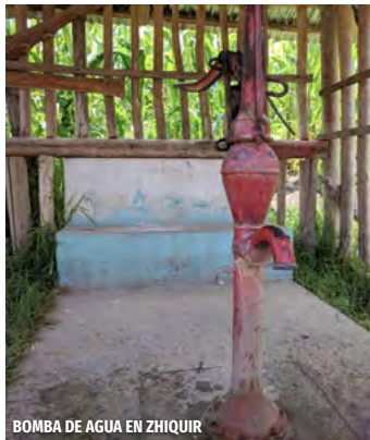
BOMBA DE AGUA EN ZHIQUIR
